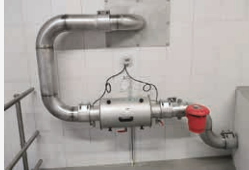
Eine Be- und Entlüftungsleitung mit speziellen Filtern sorgt für einen sicheren Druckausgleich in beiden, dicht verschlossenen Wasserkammern
