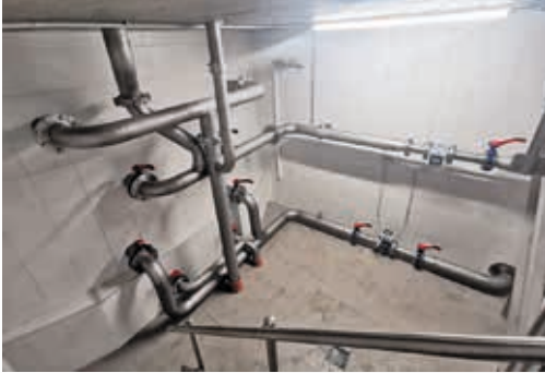
Der Blick im Rohrkeller des Hochbehälters in Richtung der Wasserkammern zeigt die Zulauf-, Entnahme- und Überlauf- bzw. Entleerungsleitungen
