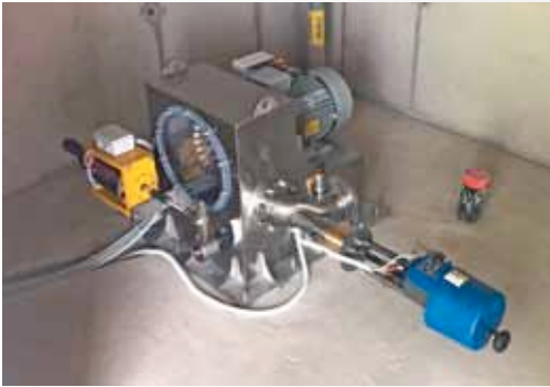
Erstes Wasserkraftwerk in der Gemeinde St. Stefan. Zu sehen die Trinkwasserturbine in Schinzengraben.
